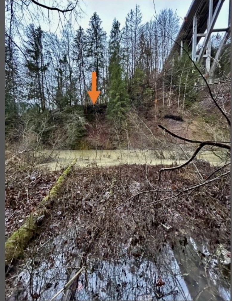
L'éperon rocheux et la culée de la rive droite sur lequel s'appuyait de ce côté le pont de 1854
